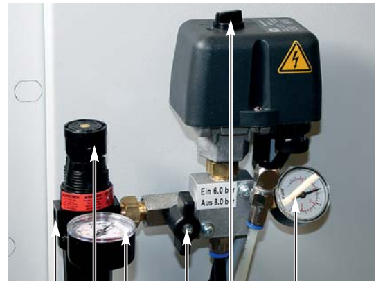
(Bild: Anlagenserie S)
